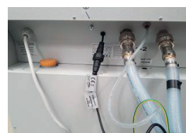
vue arrière connectique
