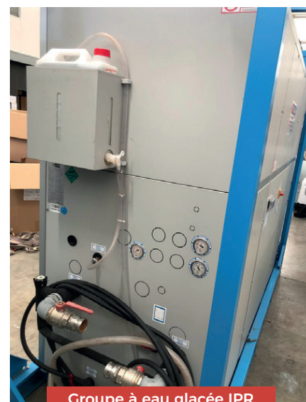
Groupe à eau glacée IPR (vue raccords)
