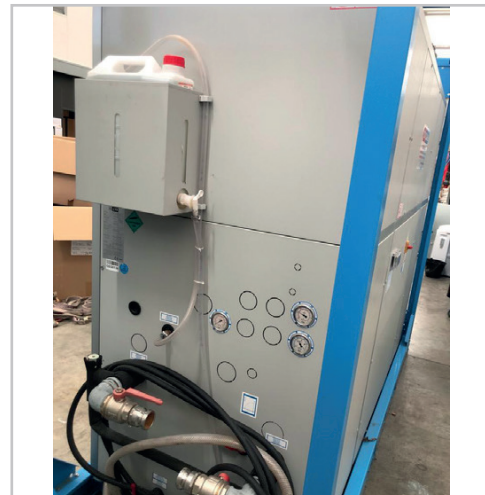
Groupe à eau glacée IPR (vue raccords)
